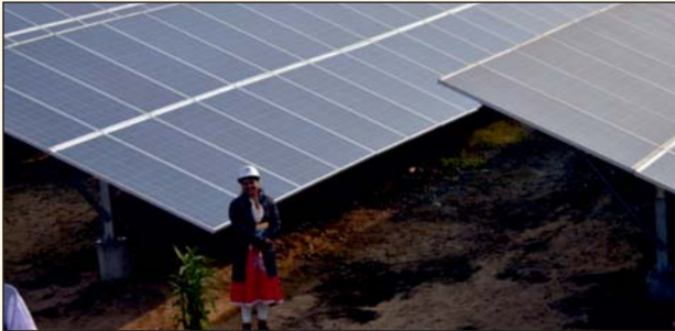
आरएसपी में पावर प्लांट के सौर पैनल।
